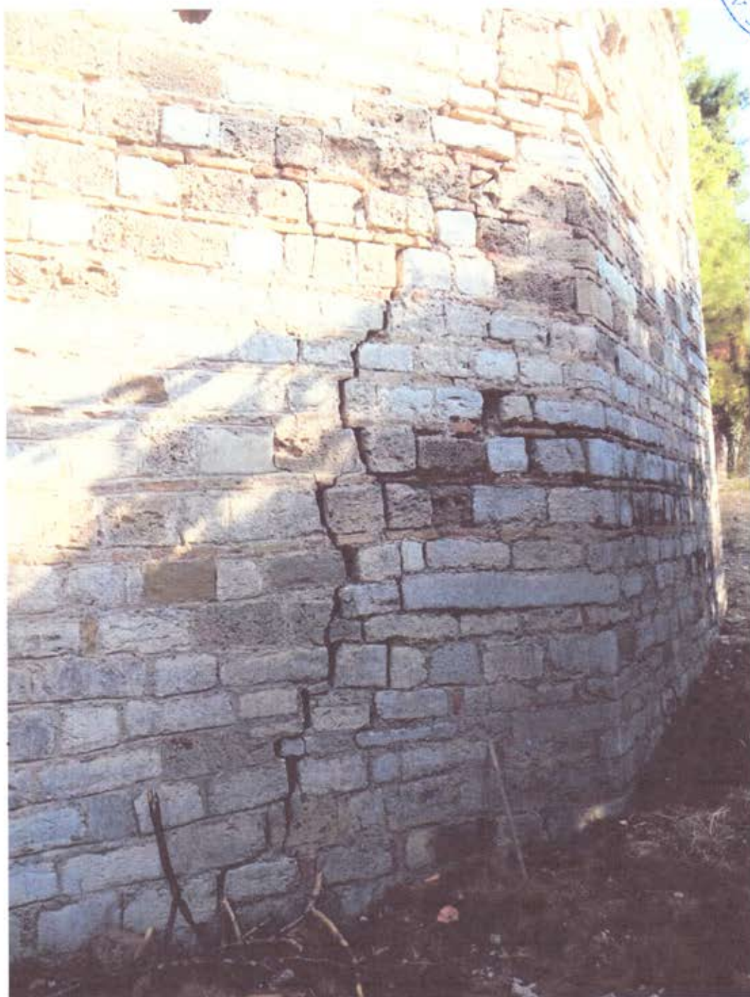
Η ρωγμή στη θέση 5.
