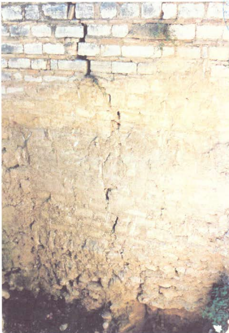
Η συνέχιση της ρωγμής στη θεμελίωση. (φωτ. από αρχείο Υπηρεσίας).
