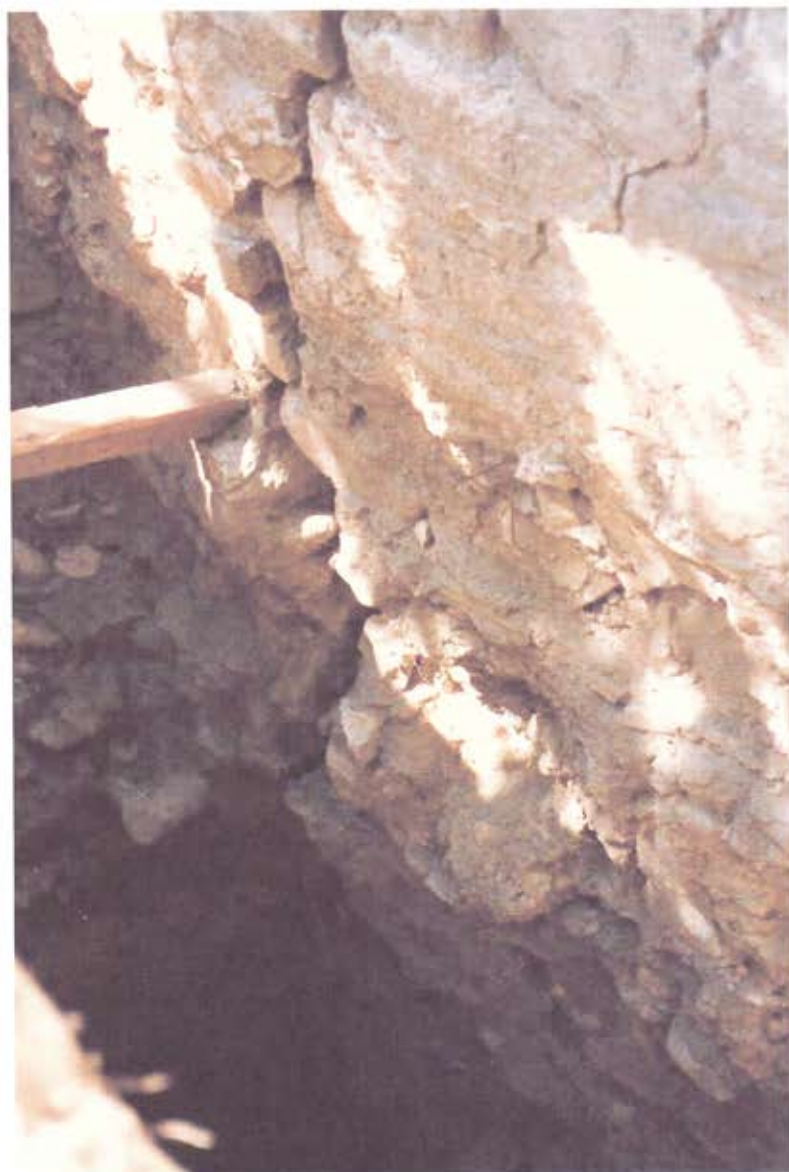
Η συνέχιση της ρωγμής στη θεμελίωση. (φωτ. από αρχείο Υπηρεσίας).
