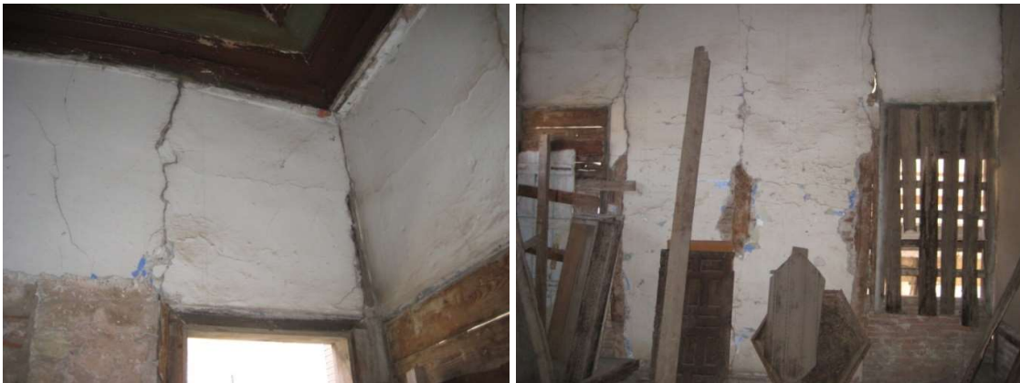
Κατακόρυφη ρωγμή στο επίχρισμα μεταξύ του ξυλόπηκτου τοίχου του σαχνισιού και του βόρειου λίθινου τοίχου του Ανατολικού οντά.
