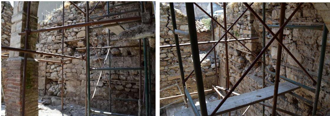
Σημαντικά προβλήματα εντοπίζονται στην Δυτική πλευρά του Αρχοντικού. Αποδιοργάνωση, αποκόλληση παρειάς τοιχοποιίας και κατάρρευση τμήματος Δυτικού τείχους κυρίως στον όροφο. Οι ξυλοδεσιές συγκρατούν τα τμήματα του τοίχου που έχουν πλήρως αποδιοργανωθεί (αριστερά).
