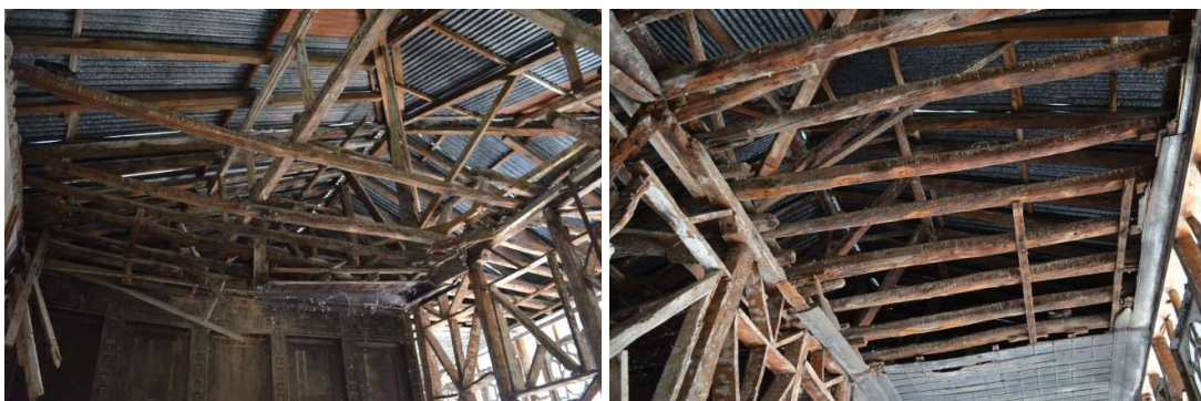
Απόψεις της στέγης. Διακρίνονται οι μη συνεχείς ελκυστήρες.
