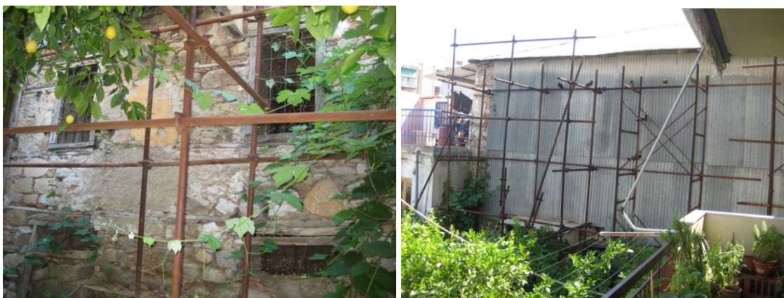
Αριστερά, τμήμα της δυτικής όψης του κτηρίου (ισόγειο - μεσοπάτωμα), δεξιά ο τοίχος του ορόφου που έχει καταρρεύσει και στη θέση του έχουν τοποθετηθεί προσωρινά λαμαρίνες. (φωτ. Μελέτη Παθολογίας, Οικονομοπούλου, Δημητρίου, 2015).
