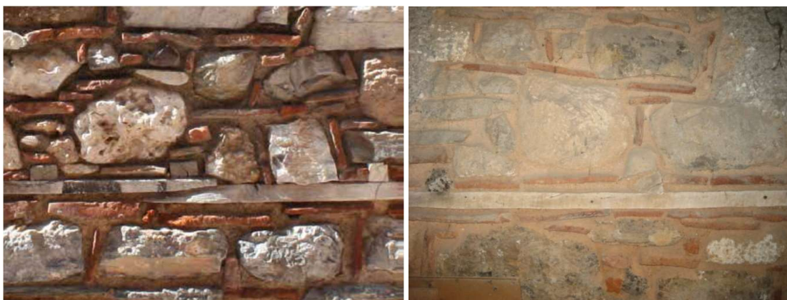
Ξυλοδεσιά σε καλή κατάσταση (αριστερά) και πλήρως κατεστραμμένη τοπικά λόγω σήψης (δεξιά).
