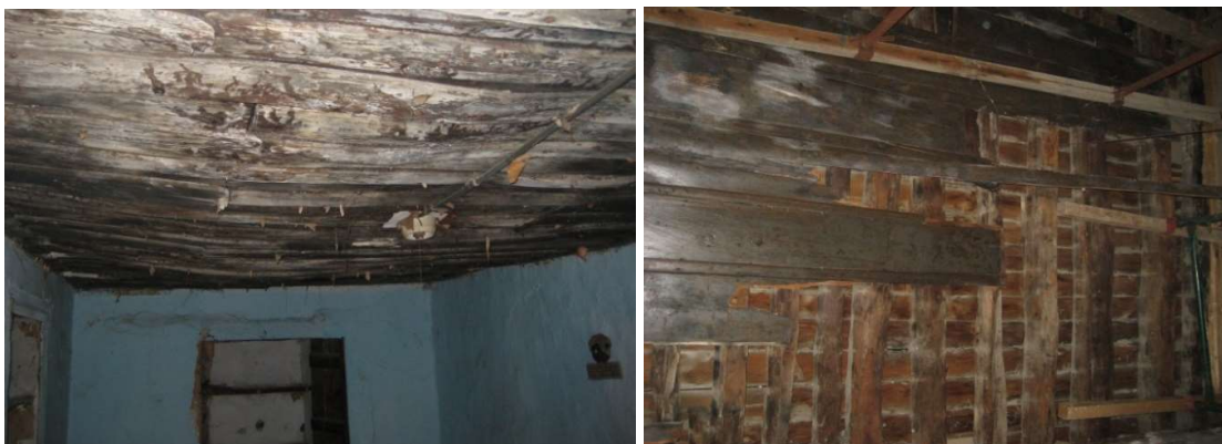
Αριστερά, η οροφή του κεντρικού δωματίου του μεσοπατώματος είναι σε κακή κατάσταση (μεγάλο βέλος και σήψη). Δεξιά η οροφή του Δυτικού δωματίου του μεσοπατώματος, κατά τόπους κατεστραμμένη (φωτ. Μελέτη Παθολογίας)
