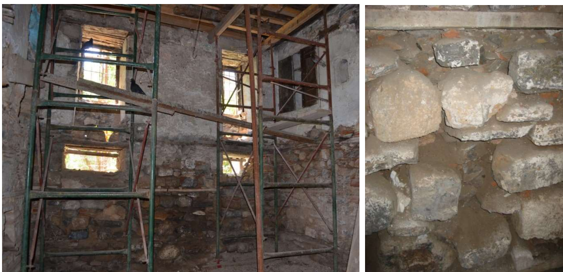
Εσωτερική όψη δυτικού τοίχου ισογείου και μεσοπατώματος. Ανερχόμενη υγρασία στο κατώτερο τμήμα των λιθοδομών. Λεπτομέρεια τοιχοποιίας, αποσάθρωση συνδετικού υλικού λόγω υγρασίας.
