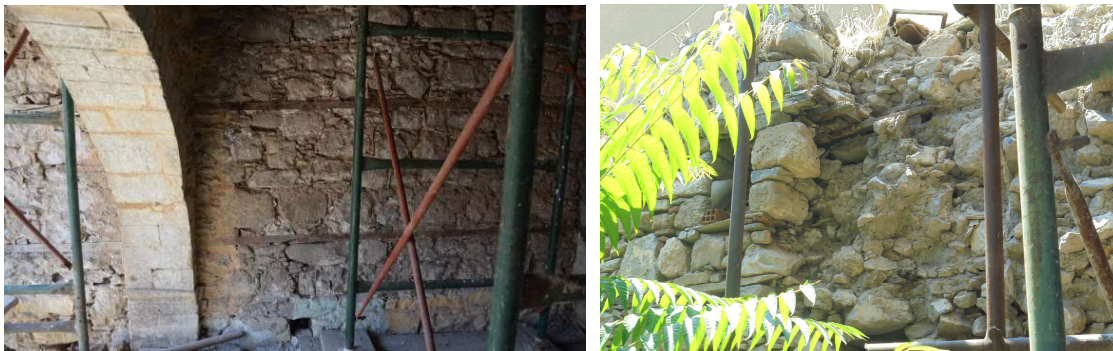
Δυτικός τοίχος διαδρόμου ισόγειου ενισχυμένος με πυκνή διάταξη ξυλοδεσιών καθ' ύψος.
