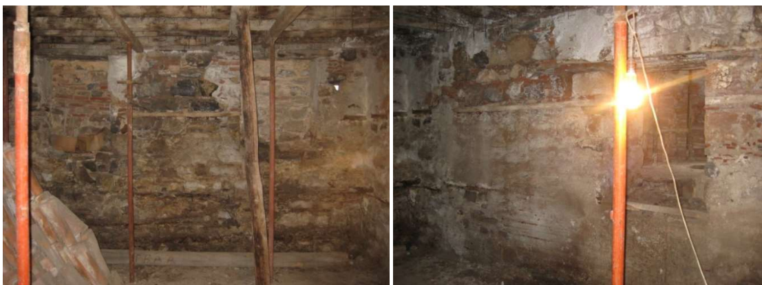
Ανατολικός χώρος ισογείου. Ανατολικός τοίχος και Νότιος τοίχος. Προβλήματα αποσάθρωσης κονιαμάτων και σήψης ξυλοδεσιών κατά τόπους, λόγω της πρόσθετης υγρασίας αφού σήμερα το επίπεδο της οδού Παίδων είναι αρκετά ψηλότερα από το δάπεδο του χώρου αυτού.
