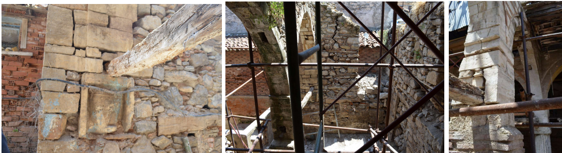
Στο δυτικό τμήμα φαίνεται να έχει αντικατασταθεί ένας κίονας με έναν πεσσό από πλίνθους. Εδραση ελκυστήρα-δοκού στο Ν άκρο της Δυτικής τοξοστοιχίας.
