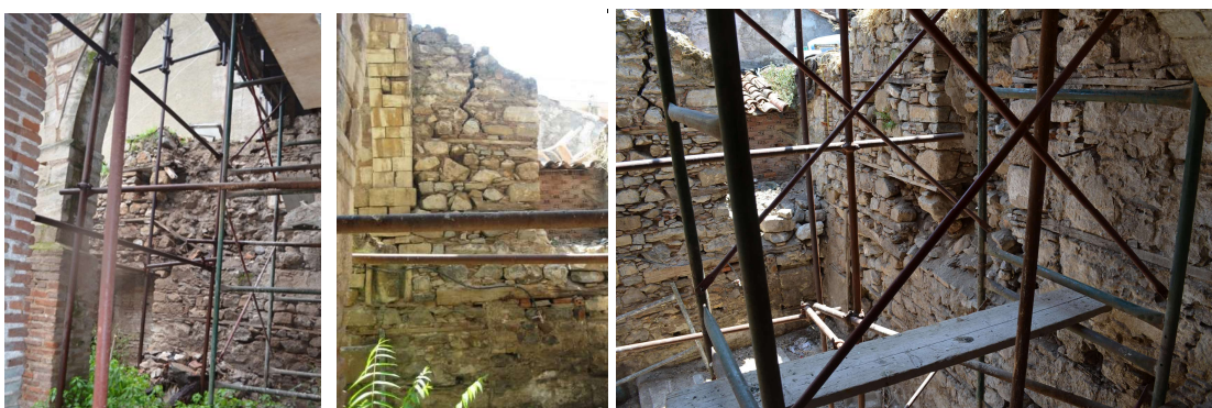
Δυτική πτέρυγα αρχοντικού. Διακρίνεται η απώλεια της εσωτερικής παρειάς του Δυτικού τοίχου. Ο Νότιος τοίχος (περιοχή έδρασης τόξου) είναι σε κατάσταση ετοιμορροπίας, με έντονες ρωγμές και τμήματα που έχουν ήδη καταρρεύσει. (φωτ. Μελέτη Παθολογίας, Οικονομοπούλου, Δημητρίου, 2015).
