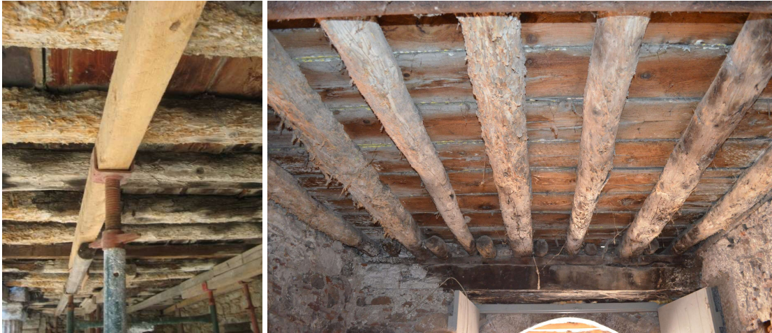
Αριστερά, οι δοκοί του διαδρόμου του μεσοπατώματος είναι σε πολύ κακή κατάσταση (εκτεταμένη σήψη). Δεξιά οι δοκοί Ανατολικού χώρου είναι σε μέτρια και κακή κατάσταση.
