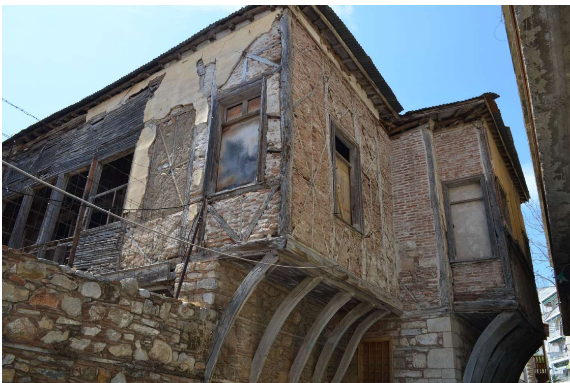
Ξυλόπηκτοι τοίχοι Ανατολικής όψης. Διακρίνεται η έλλειψη διαγωνίων στο ΒΑ σαχνισί.
