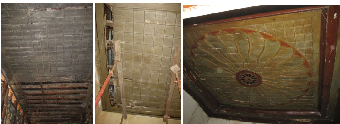
Αριστερά, η οροφή του χαγιατιού, της οποίας μεγάλο τμήμα λείπει. Στο κέντρο η οροφή του σοφά στον Ανατολικό τμήμα του χαγιατιού, έχει καταρρεύσει σε κάποια σημεία και παρουσιάζει βέλος κάμψης. Έχει υποστυλωθεί τοπικά. Δεξιά η οροφή του Ανατολικού οντά. Διατηρείται σε μέτρια κατάσταση. Ωστόσο παρατηρείται ύπαρξη βέλους κάμψης στο κέντρο περίπου της οροφής, καθώς και φθορές και αποκολλήσεις τμημάτων ξύλου (Μελέτη παθολογίας).
