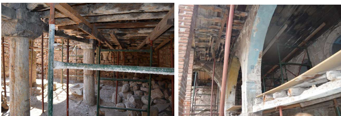
Οι δοκοί του πατωμάτων του διαδρόμου του μεσοπατώματος είναι σε μεγάλο ποσοστό σε πολύ κακή κατάσταση.
