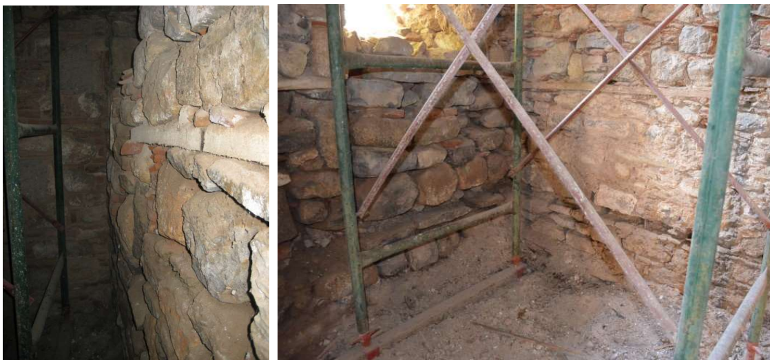
Δυτικός χώρος ισογείου. Αριστερά, καμπύλωση εσωτερικής παρειάς Δυτικού τοίχου. Δεξιά, προβλήματα αποσάθρωσης κονιαμάτων και σήψης ξυλοδεσιών στον Δυτικό και Βόρειο τοίχο.
