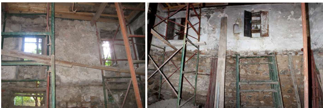
Δυτικός χώρος μεσοπατώματος. Το πάτωμα έχει καταρρεύσει. Ο Βόρειος και Νότιος τοίχος παρουσιάζουν κυρίως κατά τόπους αποκολλήσεις και ρηγματώσεις στο επίχρισμα (φωτ. Χ. Μπασούκος).
