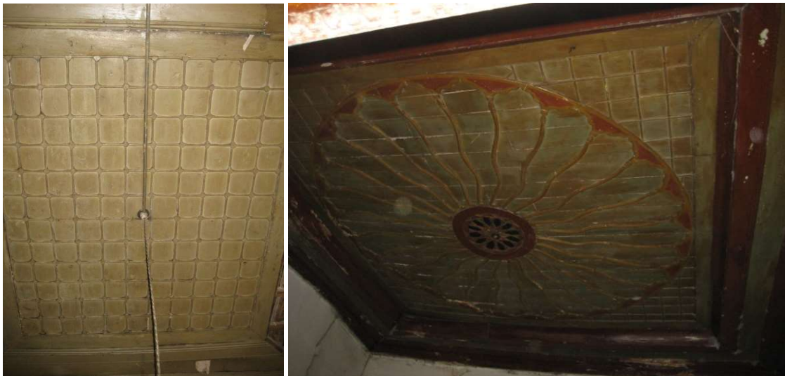
Αριστερά η οροφή του ευβάν, σε καλή κατάσταση, με κάποιες βλάβες και αποκολλήσεις στο άκρο της. Δεξιά η περίτεχνη οροφή του Ανατολικού οντά, παρότι η κατάσταση της είναι καλή, με τοπικές φθορές, παρουσιάζει βέλος στο κεντρικό της τμήμα.
